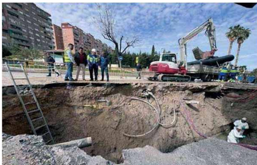
Imagen del tremendo socavón en la avenida de Arjona, que ya ha sido reparado. VIVA JAÉN
